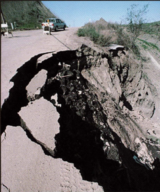
Caída de banca en carretera, Italia
