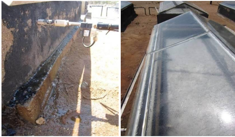
Foto 3.54 Electroválvula y destilador solar
