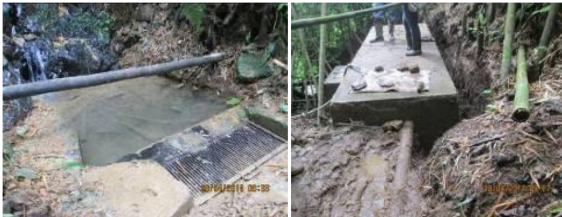
Foto 3.23 Captación y desarenador
