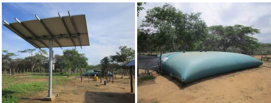
Foto 3.37 Sistema de energía solar y tanque de almacenamiento flexible
