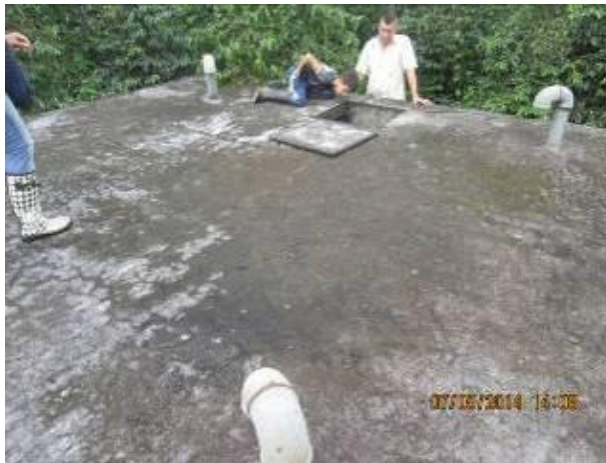
Foto 3.19 Tanque de almacenamiento Acueducto San Martín y fuente Tijuana
