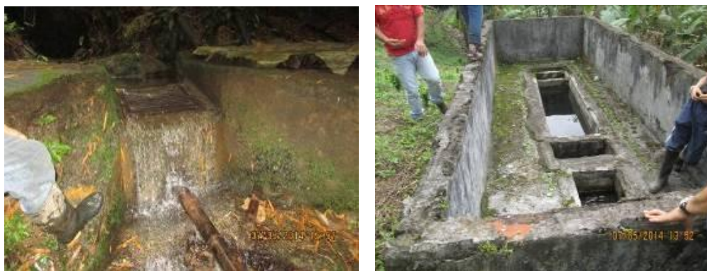
Foto 3.18 Captación y desarenador Acueducto San Martín
