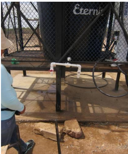
Foto 3.51 Llave en mal estado
