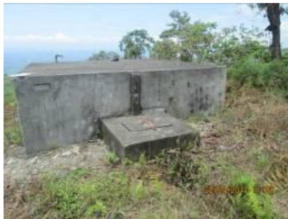
Foto 3.24 Tanque de almacenamiento
