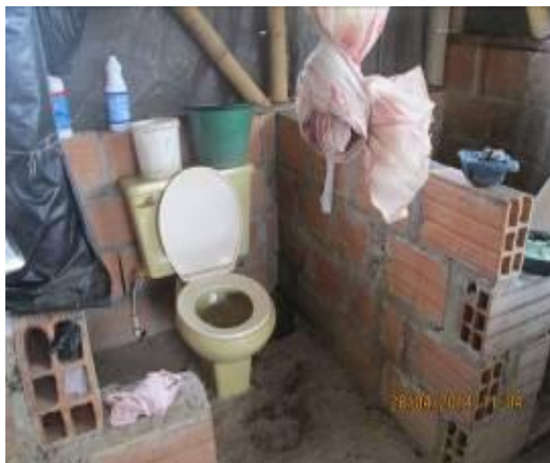
Foto 3.26 Unidades de evacuación de excretas
