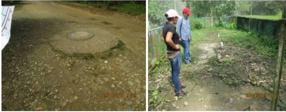
Foto 3.9 Cámara de inspección alcantarillado y tanque séptico comunitario
