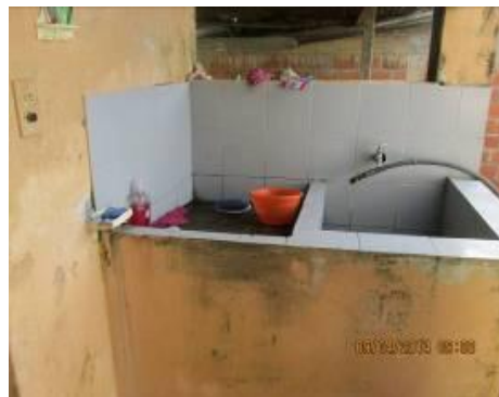
Foto 3.10 Punto de lavado de manos en las viviendas
