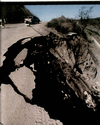
Caida de banca en carretera, Italia
