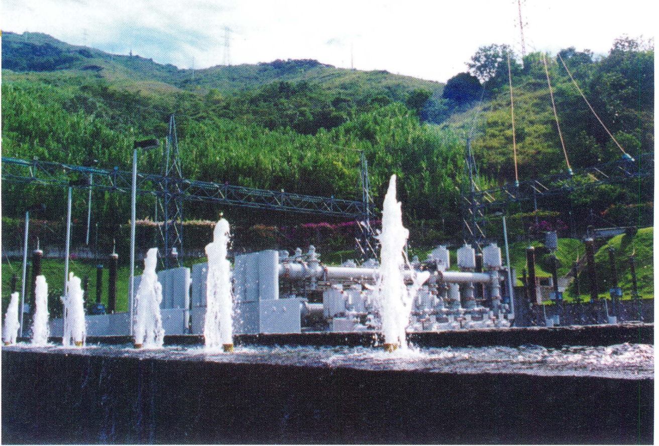
▲ SUBESTACIÓN CENTRAL HIDROELÉCTRICA LA TASAJERA
